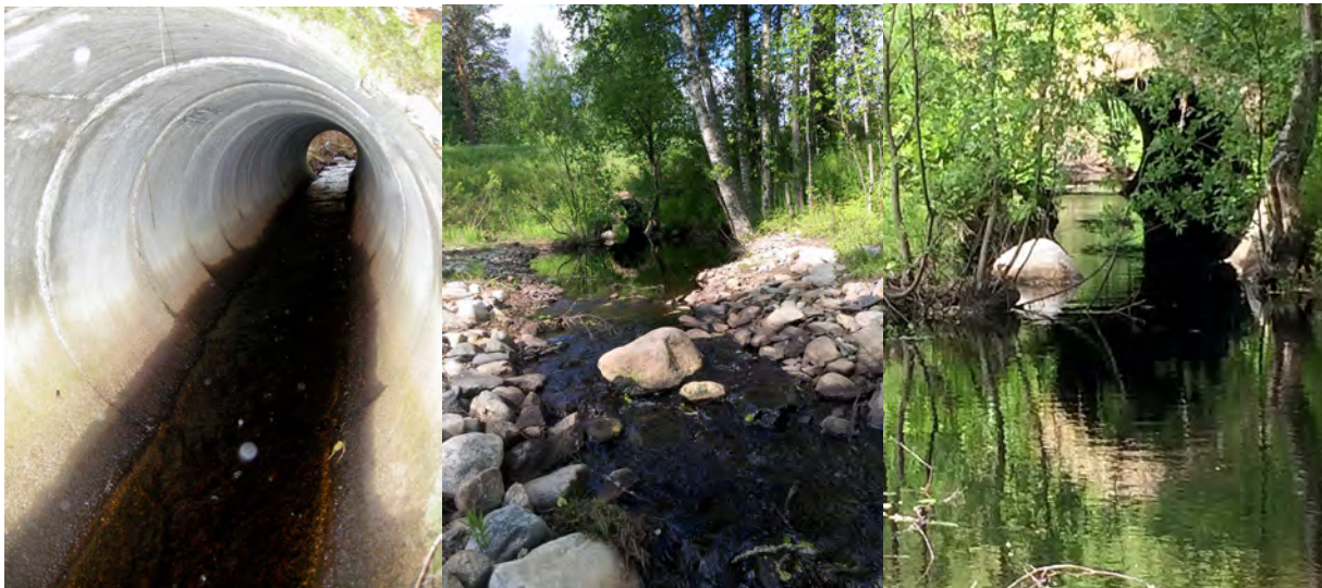
Bild 4. Bilden till vänster visar en trumma där det är hög vattenhastighet, till mitten och till höger visas samma objekt efter åtgärd där trösklar anlagts nedströms för att höja vattennivån och sänka vattenhastigheten (ID 280).
