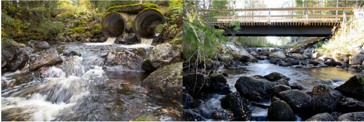
Bild 2. Bilden till vänster visar på en dubbeltrumma där det är hög vattenhastighet och ett fall har bildats vid utloppet. Till höger samma objekt efter åtgärd där en bro är anlagd (ID244).
