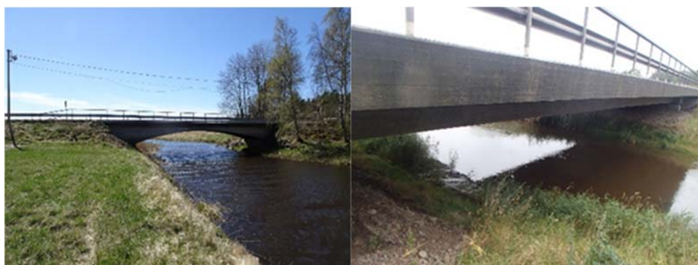
Figur 4.6.4:3 Vänster: Befintlig bro över Nossan vid Södra Härene kyrka väg, höger: Bro över Nossan sv Ribbingsberg.
