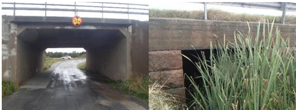
Figur 4.6.4:2 Vänster: Befintlig bro över enskild väg Höger: Bro över bäck vid Fötene
