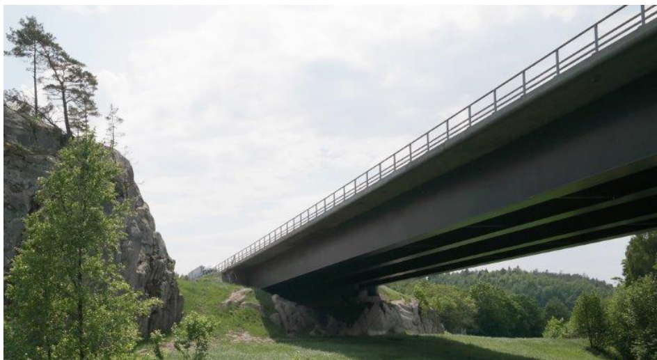
Bild 12. Bro i bergsskärning läggs så att den ligger på berget. Foto: Josefina Lenning.
