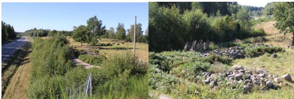
Figur 20. Stenröse vid km 27/150 som kommer i konflikt med breddningen av vägen samt flytt av enskild väg, se MKB.
