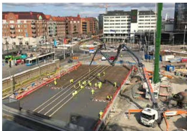
Över schaktet bygger vi en bro som leder alla trafikslag genom Korsvägen i nord/sydlig riktning. Bild: ?????
