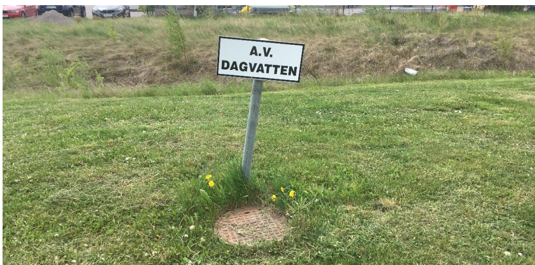
Bild 13 Avstängningsventil utgående flöde från befintlig dagvattendamm
