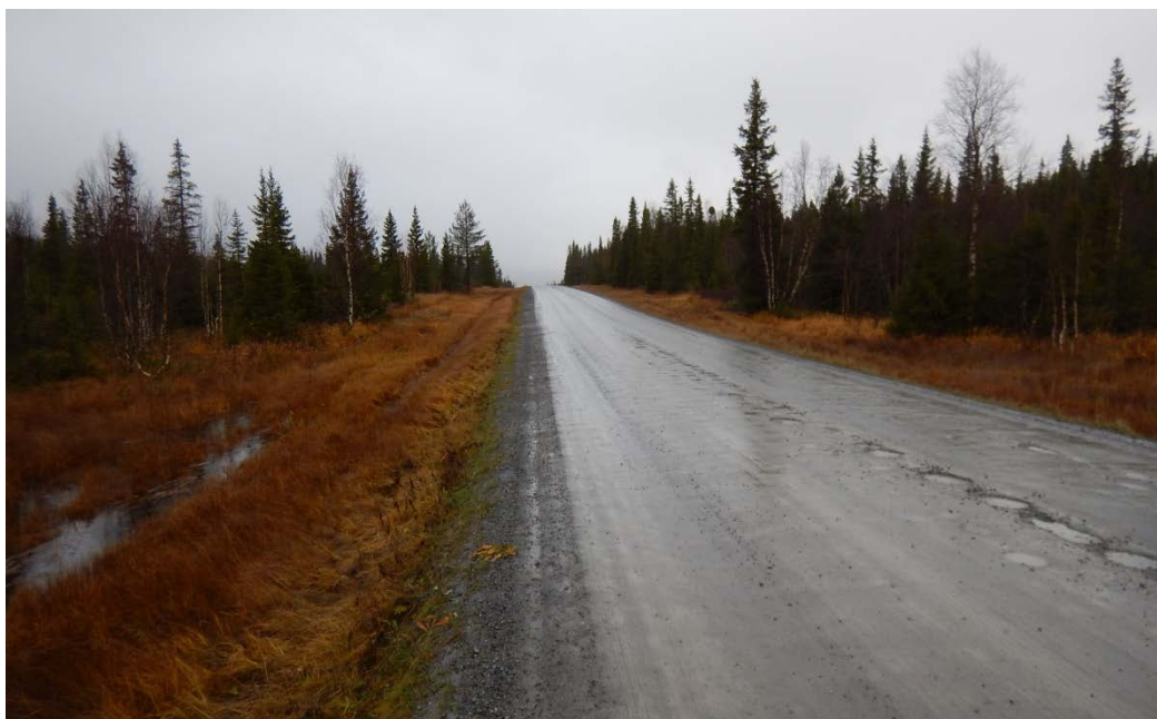
Figur 4. Avsnitt av väg 662 med dåligt fungerande diken och ojämn vägbana.
