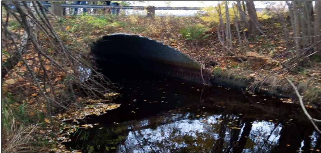
Figur 3.5.1-3. Rörbro som leder Borån under befintlig väg, väster om väg 27.
