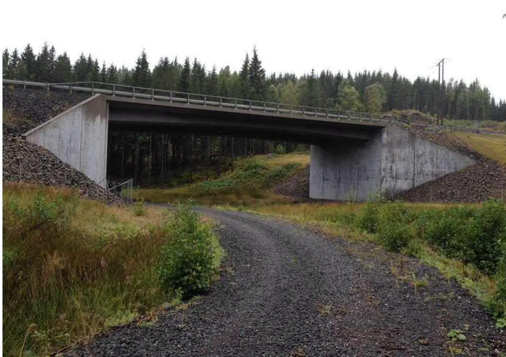
Figur 6. Exempel på vägport anpassad för viltpassage, denna under väg 31 nordost om Tenhult (foto Henrik Wahlman).
