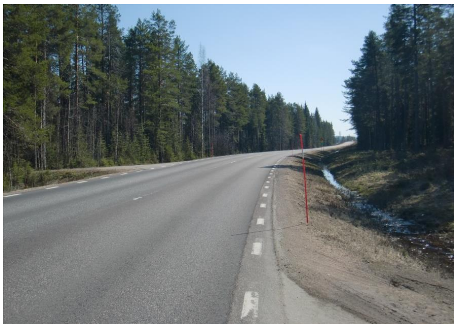
Figur 2. Bristfällig sikt försvårar omkörningsmöjligheterna och begränsar framkomligheten.
