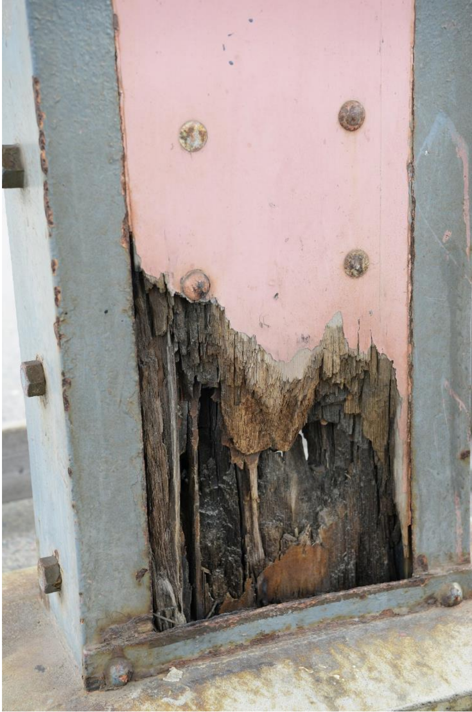
Figur 27 Rötskador nedtill på stolpe.
