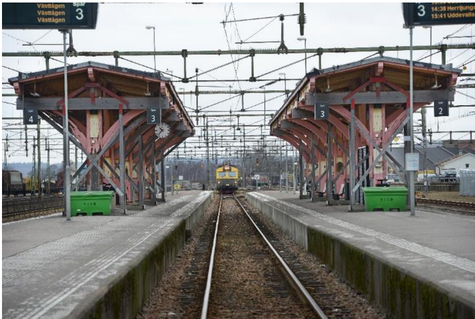
Figur 10 Plattformstaken vid Varbergs station. Notera stöden som säkrar taken.
