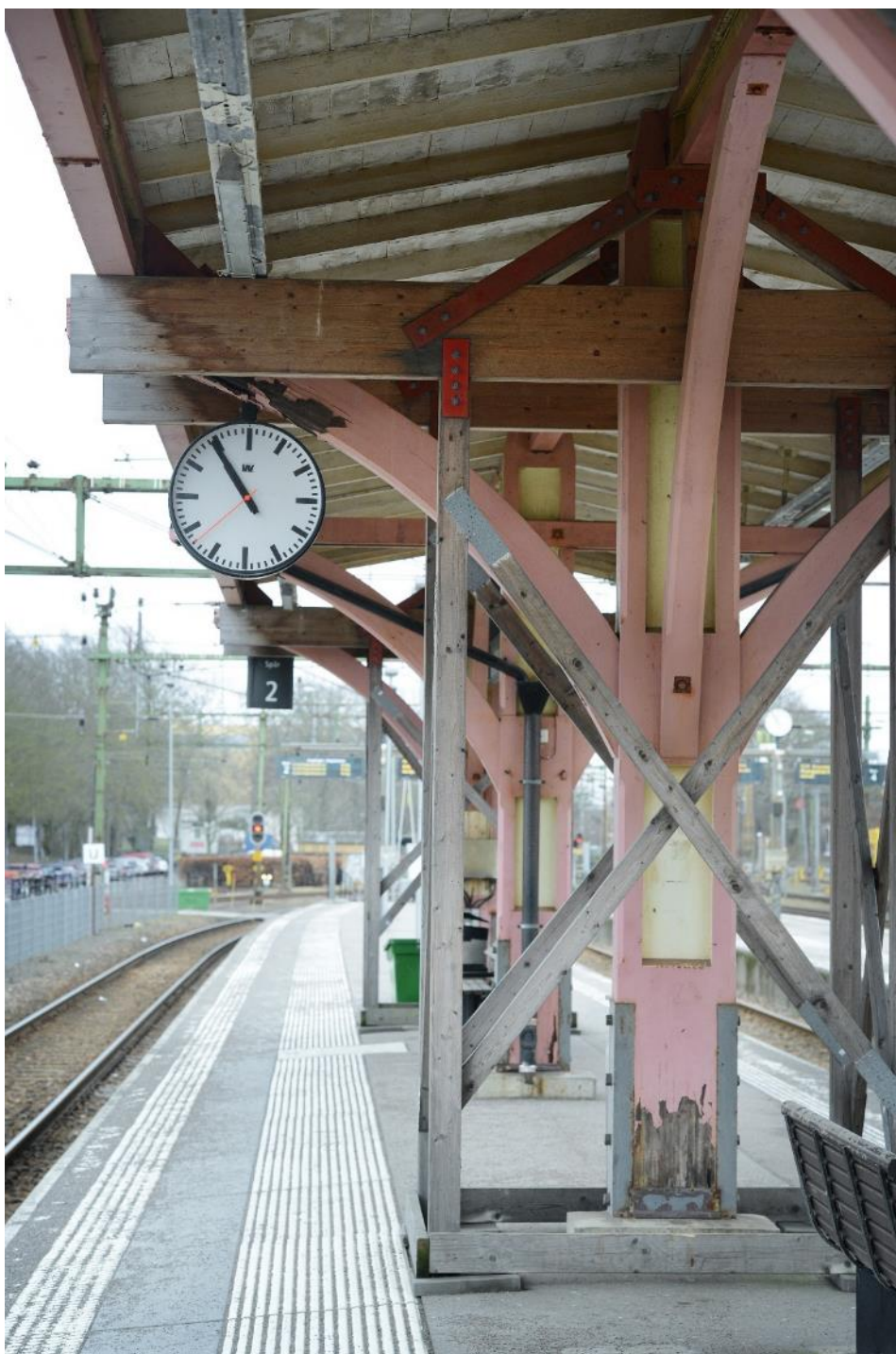
Figur 34 Östra plattformstaket sett mot söder. Stöttor håller upp taket.
