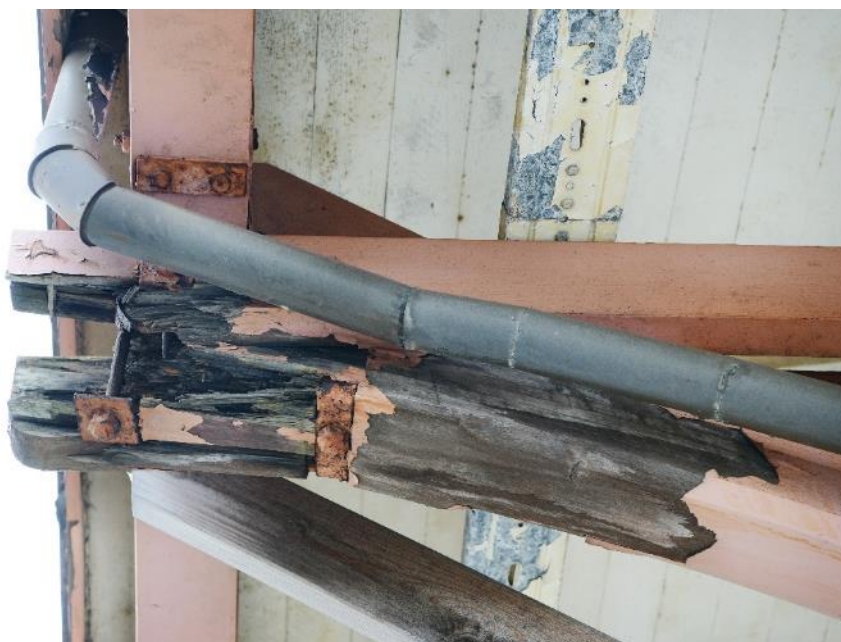
Figur 26 Rötskador på stöd vid taksfoten.
