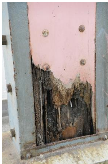
Figur 14 Rötskador nedtill på stolpe.
