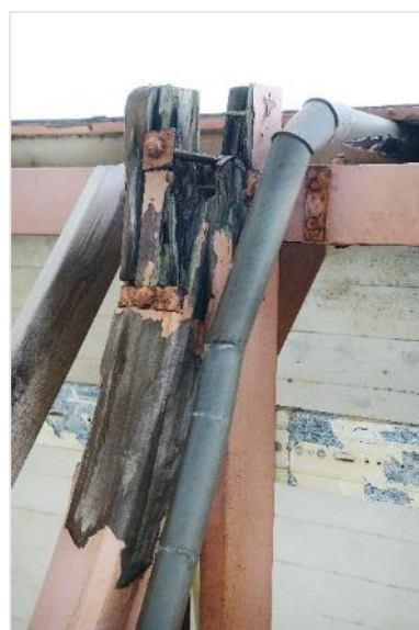
Figur 13 Rötskador på stöd vid takfoten.
