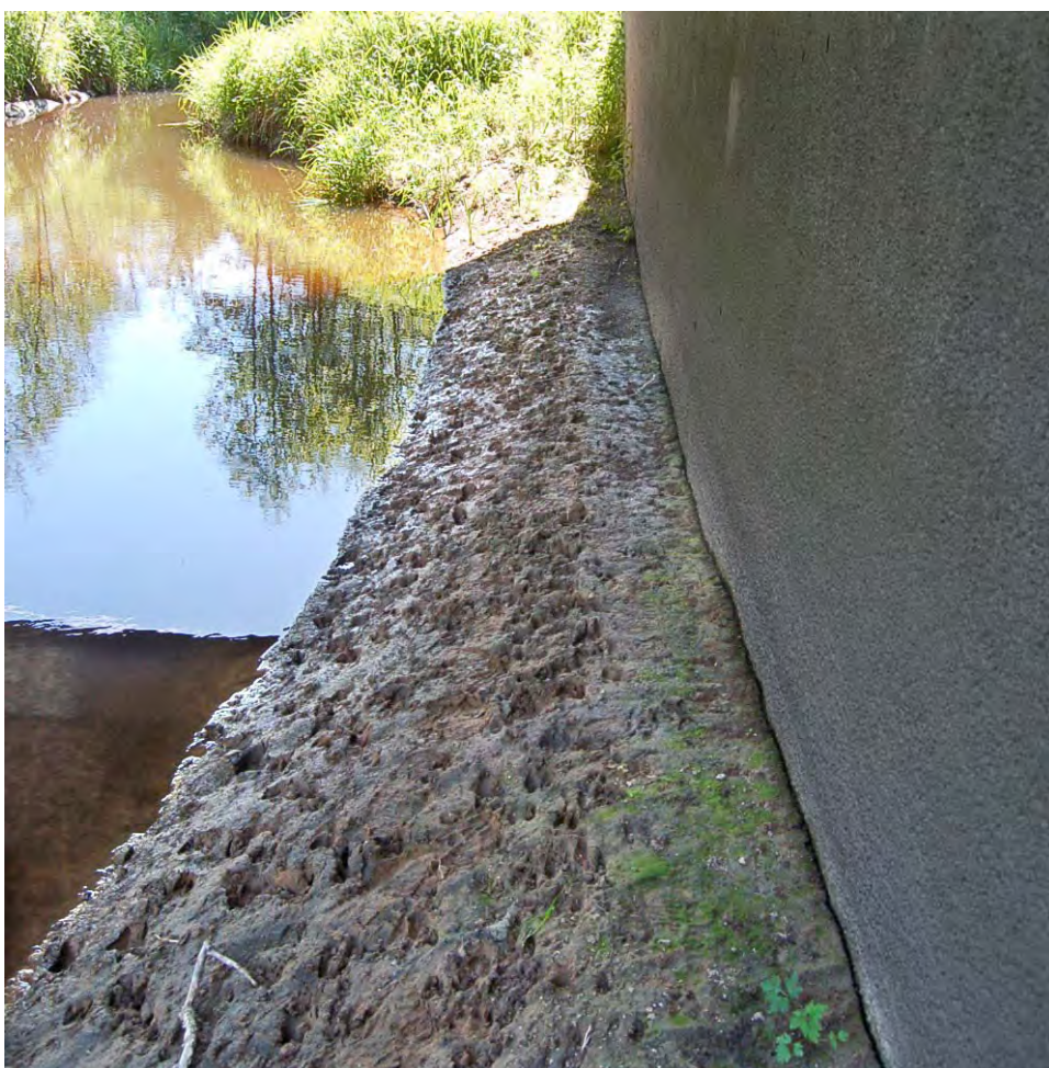
Delsträcka B. På översta bilden syns stamvalvbron strax till vänster. På nedersta bilden syns rikligt med djurspår under befintlig bro.
