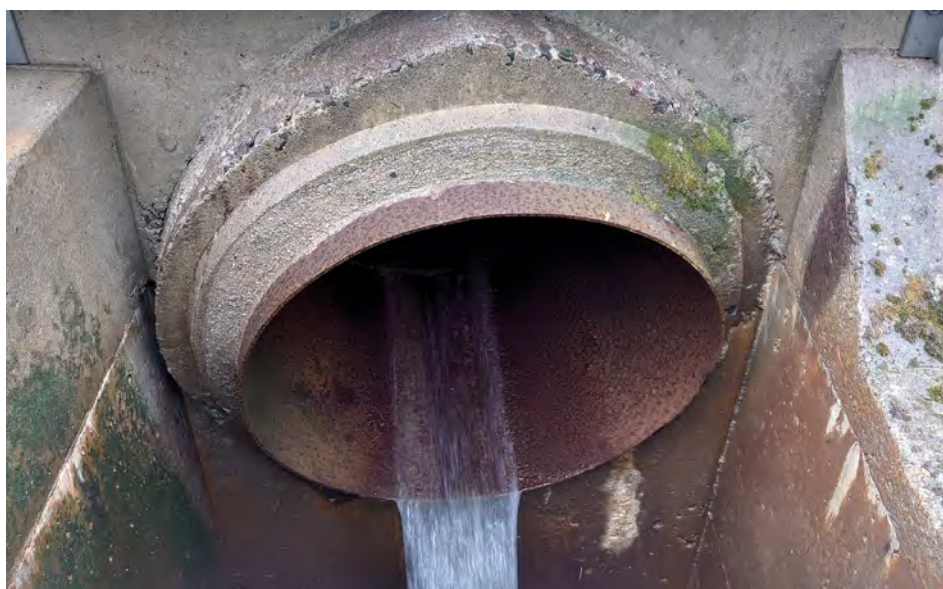
Figur 3.5:11 Stalp i Stavsättsbäcken som utgör ett vandringshinder
