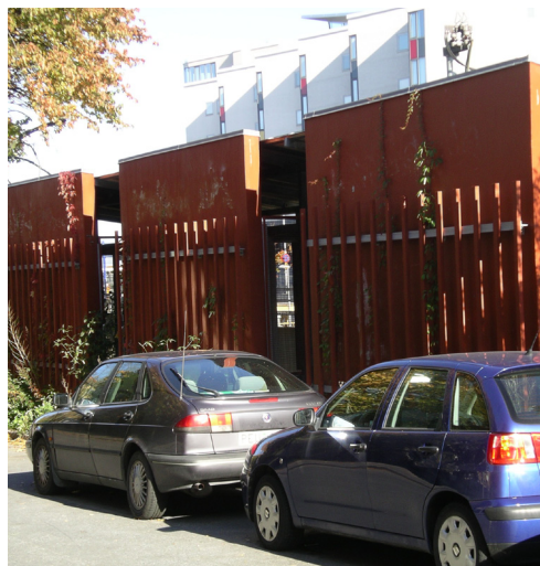
Exempel på friskluftsintag vid Södra länken.
