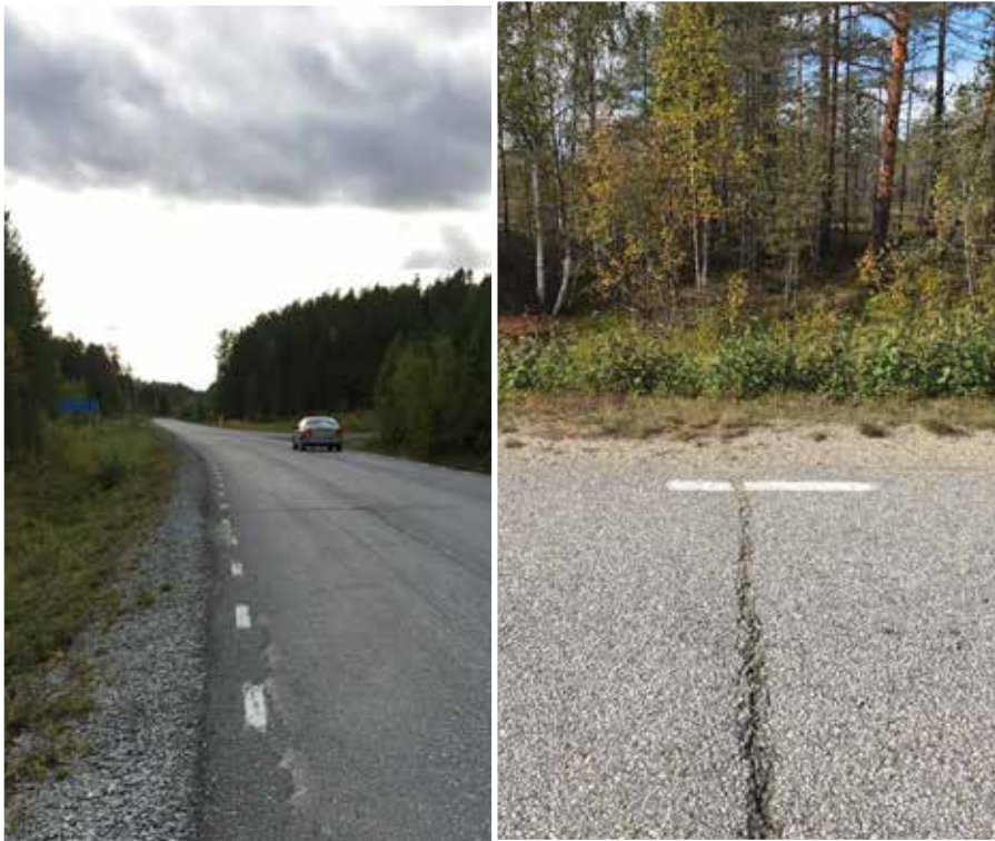
Figur 2. Befintlig väggropp med sprickbildning och andra skador.
