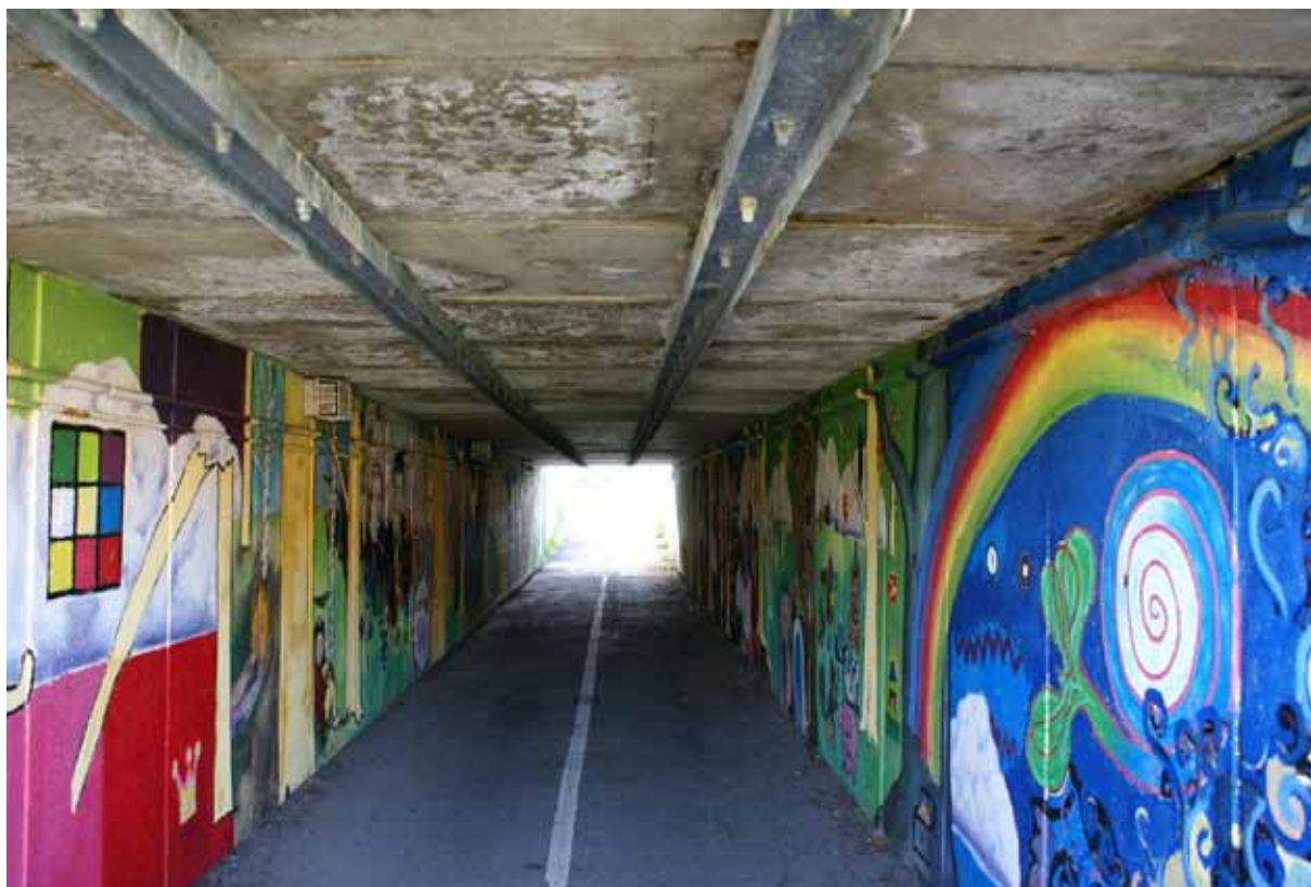
Bild 4.15 Passage under E 20 vid Hova - i stort behov av underhåll
