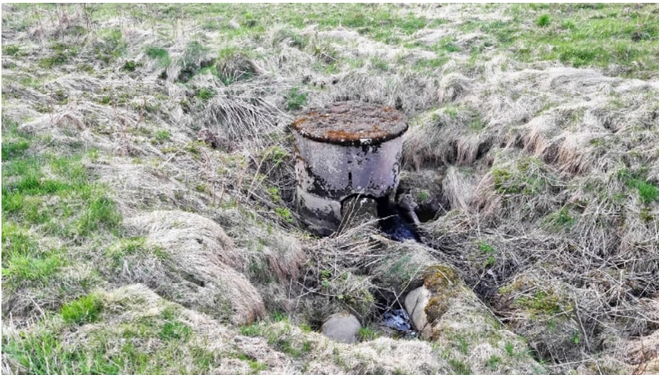
Foto 11. Brunnen som ska bytas ut, nuvarande skick.
