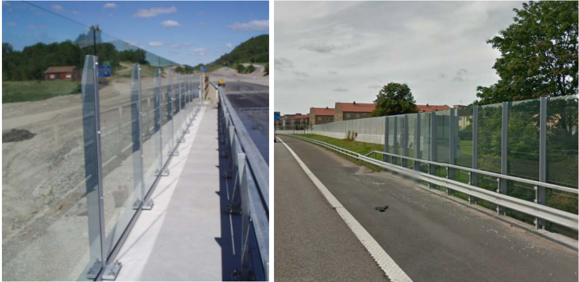
Figur 17. Vänstra bilden visar skärm monterad på breddad kantbalk och högra en skärm monterad direkt på broräcke.
