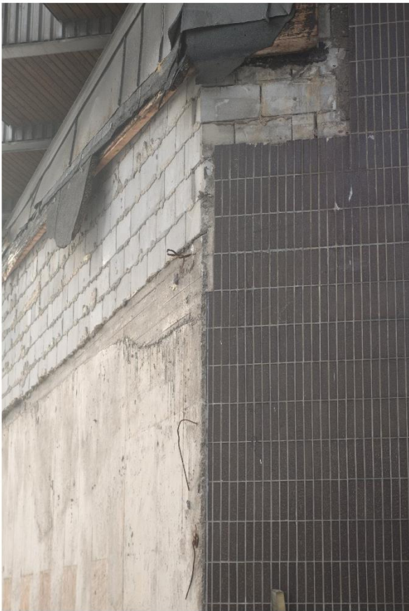
Figur 24: Keramiska plattor på den undre delen av byggnaden. Till vänster i bild har den avrivna servicebyggnaden tidigare anslutit. (Foto WSP 2018-03-07)
