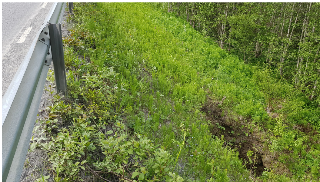
Figur 31. Till följd av att trumman rasat in har jordmassorna i vägsälanten rasat in och det har bildats ett slukhål.
