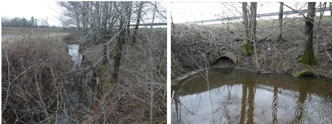
Figur 38. T.v. växtlighet och vattenspiegel i delen av diket som löper längs med väg 23 och påverkas av biotopförlust. T.h. Stående vattenspiegel och brett dike kring trummorna under väg 23 vid km 5/590 som har undermålig funktion och igensättningsproblematik. Trumma t.v. i bilden bedöms inte längre vara i bruk.
