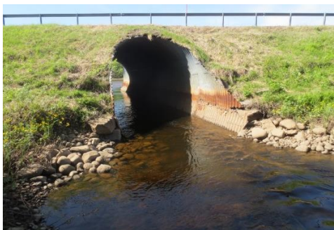
figur 4. Befintlig bro under väg 97 vid Sävaståns utlopp mot Bodån, inloppssida. Rostangrepp utgör en risk för bronns funktion.
