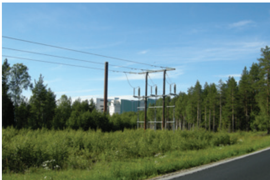
Figur 3.3-1 Dåva kraftvärmeverk. Foto: Tyréns AB.
