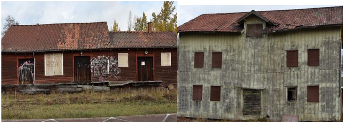
Figur 11. Vänster bild: Det röda godsmagasinet/södra fasad med raserad lastbrygga av trä. Höger bild: Det gröna kolhuset/godsmagasinet/södra fasad.
