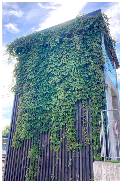
Figur 32. Hiss med vägg klädd med träribbor, beväxande med klängande växter. Exempel från Knivsta station.
