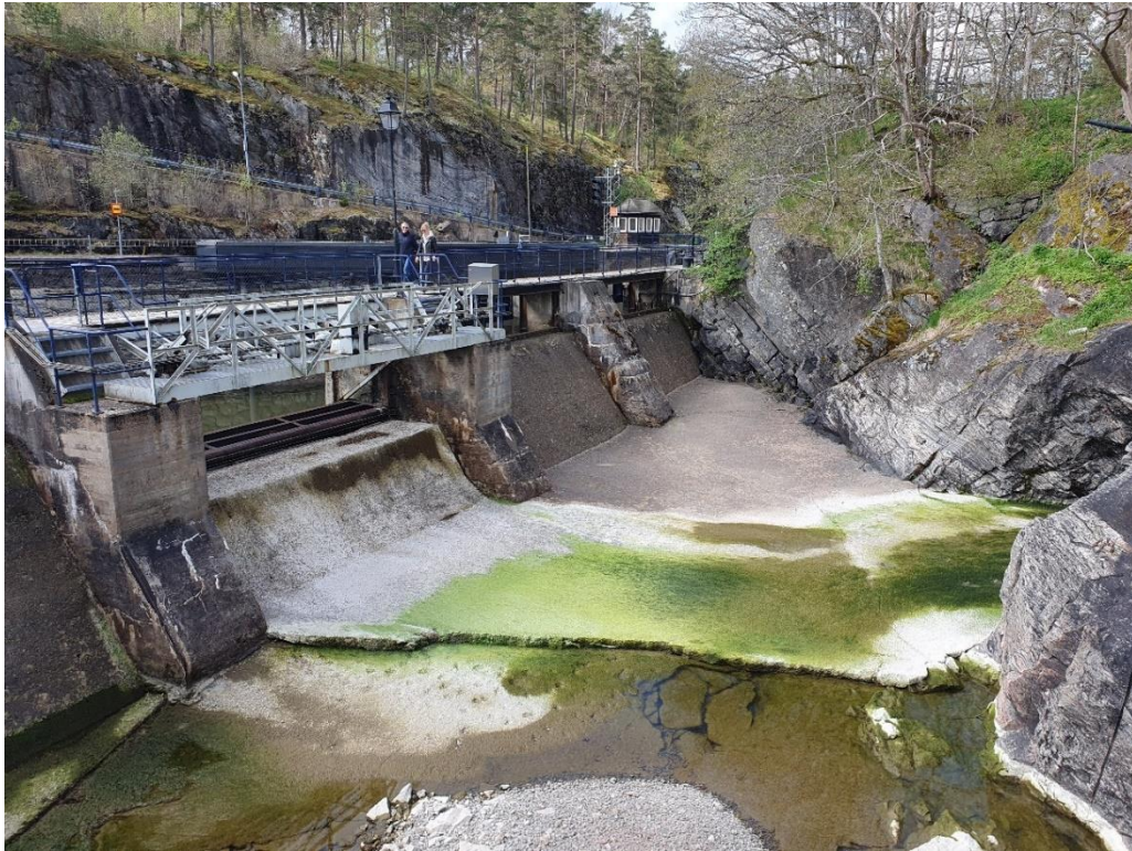
Figur 33. Kombinerat bräddavlopp och isutskov med fällbar lucka. Slussleden syns i bakgrunden. Foto mot sydväst.
