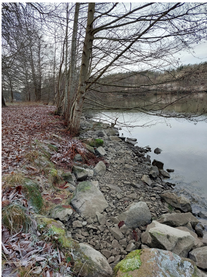
Figur 3. Befintligt erosionsskydd vid Åkersvass, norr om de gamla slussarna. Foto taget mot sydväst.
