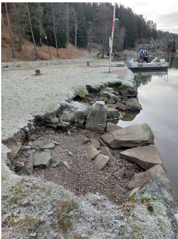
Figur 5. Pågående erosion vid skadad kajmur söder om 1800-års slussar. Foto taget mot söder.
