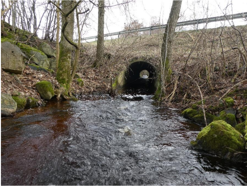
Figur 33. Utlopp på trumma ligger en bit högre än anslutande dikesbotten vilket dels skapar turbulens i vattnet och medför att trumman utgör ett partiellt vandringshinder. Väster om vägen, bild tagen mot öster.
