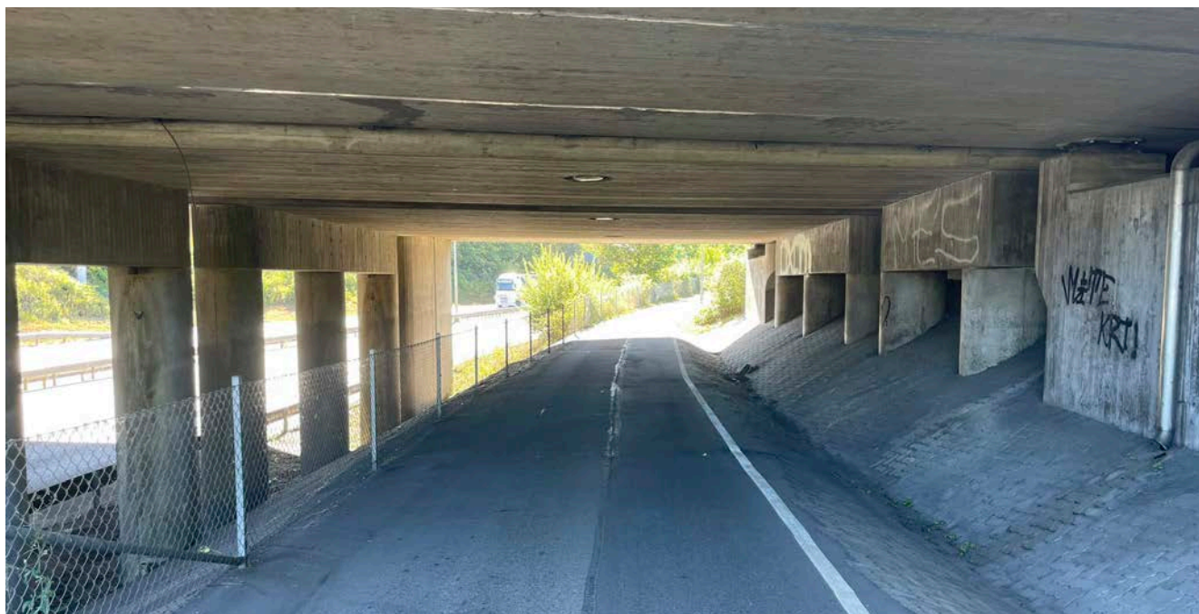
Figur 26-Foto som visar befintliga broar. Till höger syns pelare och nicher där någon potentiellt skulle kunna gömma sig.
