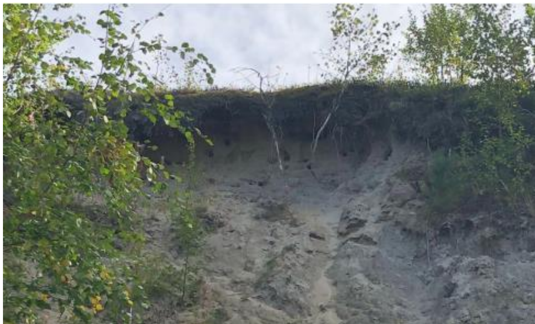
Figur 3–2. Foto över slänt med överhängande växtlighet och fågelbon. Notera även spår från rinnande vatten av förmodat ytvatten i slänt.
