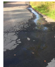
Bild 2 Bärighetsbrist på grund av vattenkanal
