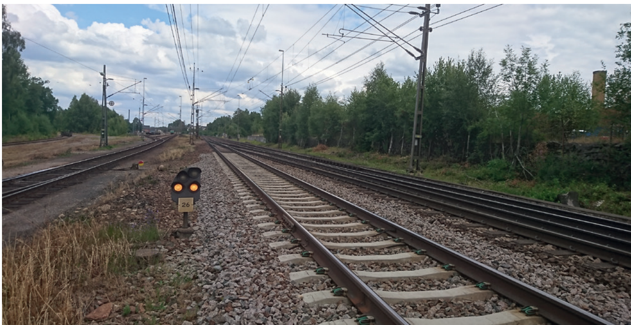
Den efterföljande dvärgsignalen (Äh 26) där tåget stannar. Avståndet mellan huvudsignalen och dvärgsignalen uppskattas till ca 265 meter.
