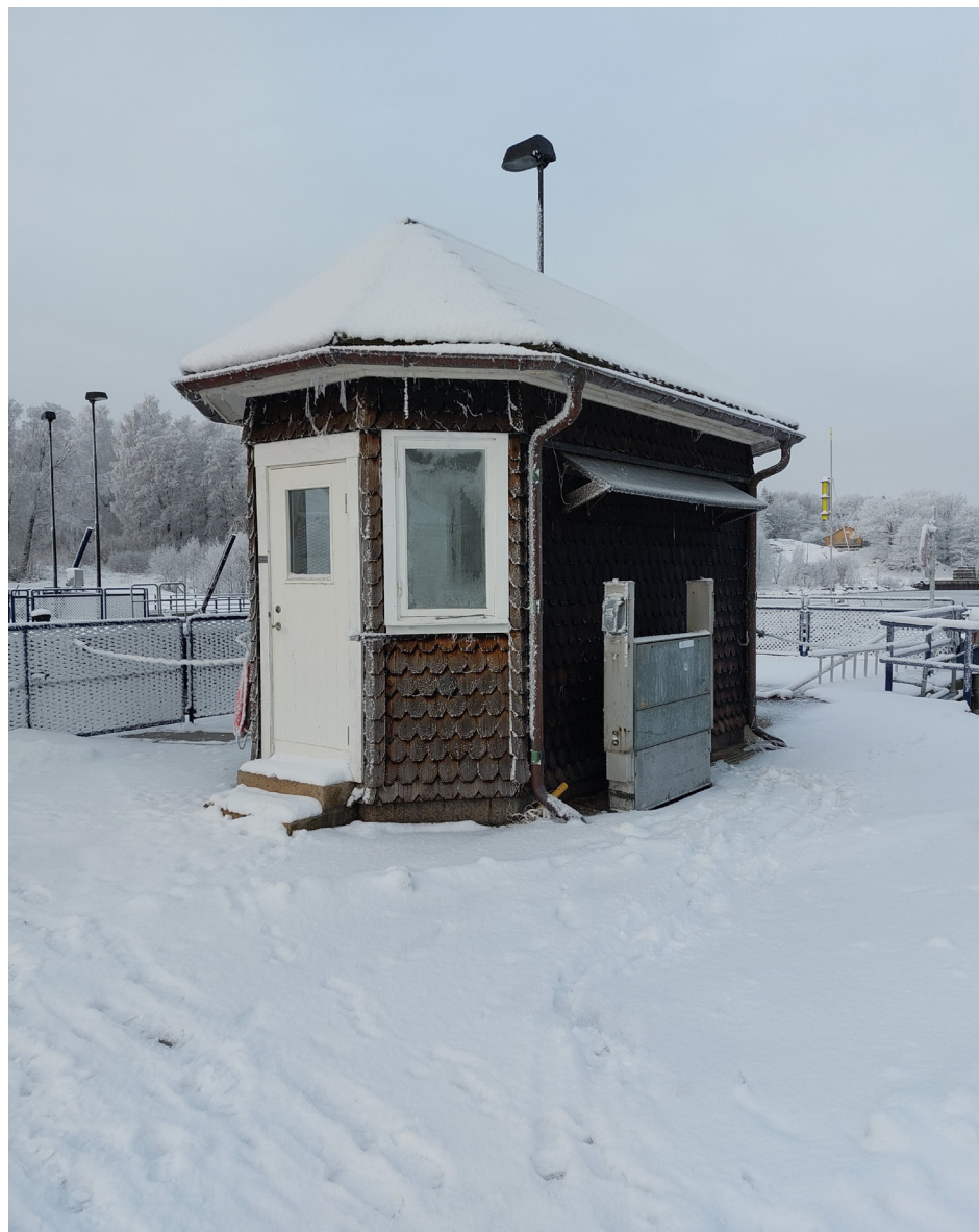
Figur 133. Manöverhyttan fotograferad från sydost. Utbytt fönster och dörr är inte anpassade till byggnadens karaktär.
