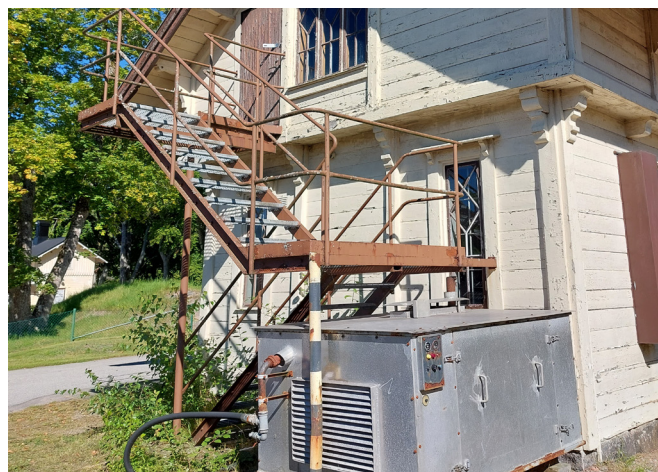
Figur 123. Olika teknikdon och en icke anpassad trappa förvanskar byggnaden, som i övrigt är mycket välbevarad.
