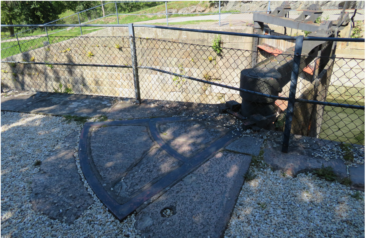
1844 års slussar. Bevarade tekniska installationer för slussportarna.
