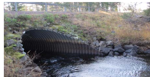
Bild 19. Rörtrumma med erosionsskydd av kross
