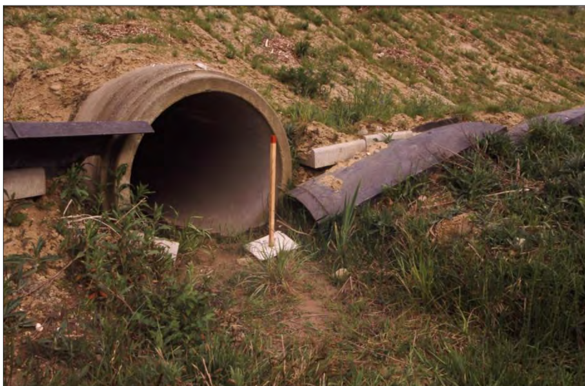
Trasig infästning mot rör (grodtunnel). Förutom olämpligt anslutningsmaterial är det svårt att få till en tät infästning mot ett rör jämfört med en rektangulär grodtunnel. Foto: Claes Andrén.
