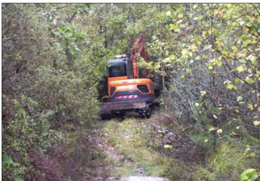
Figur 7. Den norra delen av utredningsområdet var till stora delar bevuxen med tät slyskog. Grävmaskinen röjer sig fram mot objekt 1. Foto: Bengt Westergaard.
