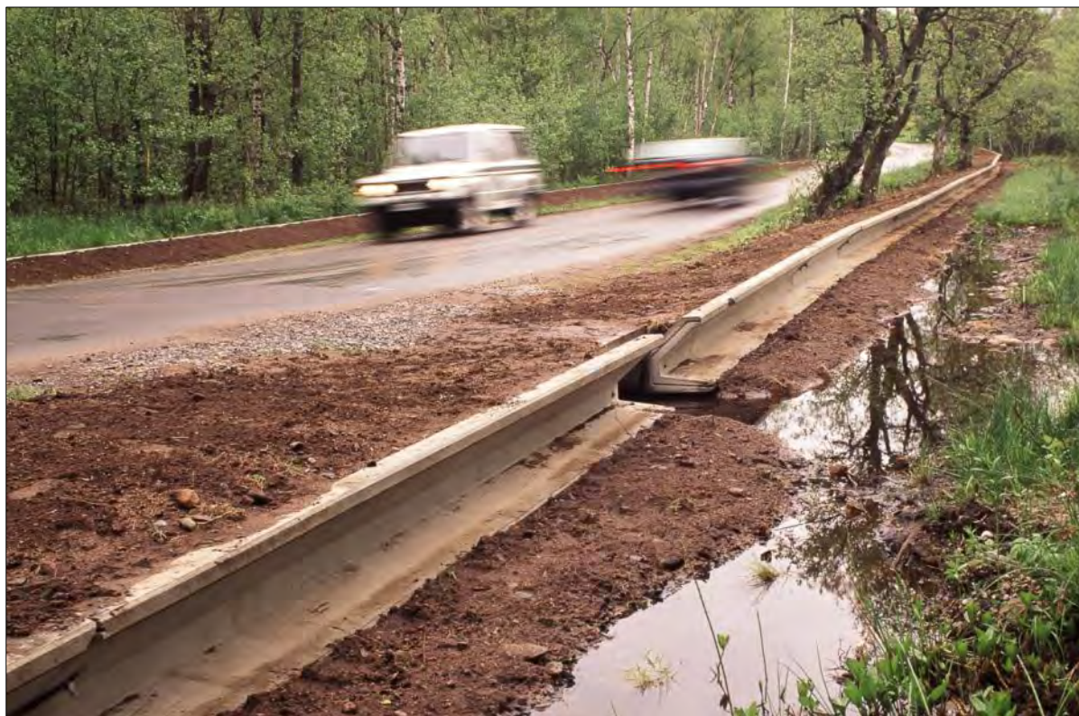
Exempel på infälld mur (i betong) med "armar" som leder groddjuren in till en rektangulärt utformad fauna-passage. Foto: Claes Andrén.
