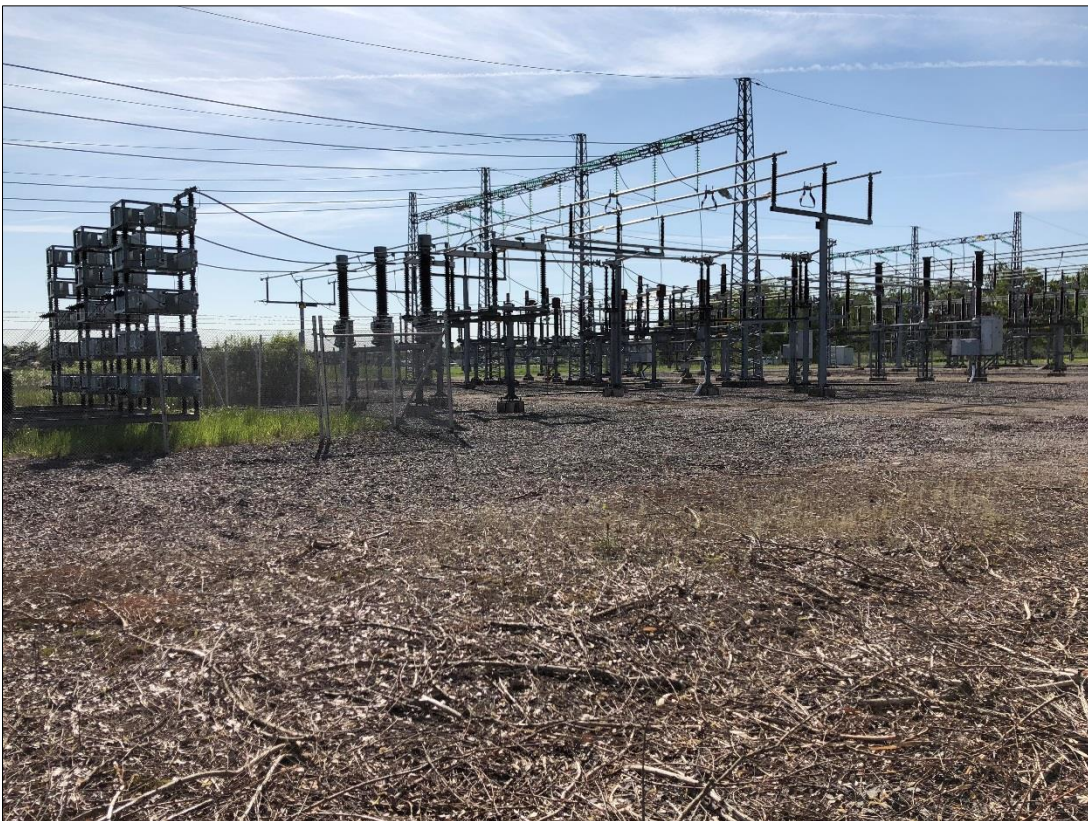
Figur 5. Ställverket från nordväst.
