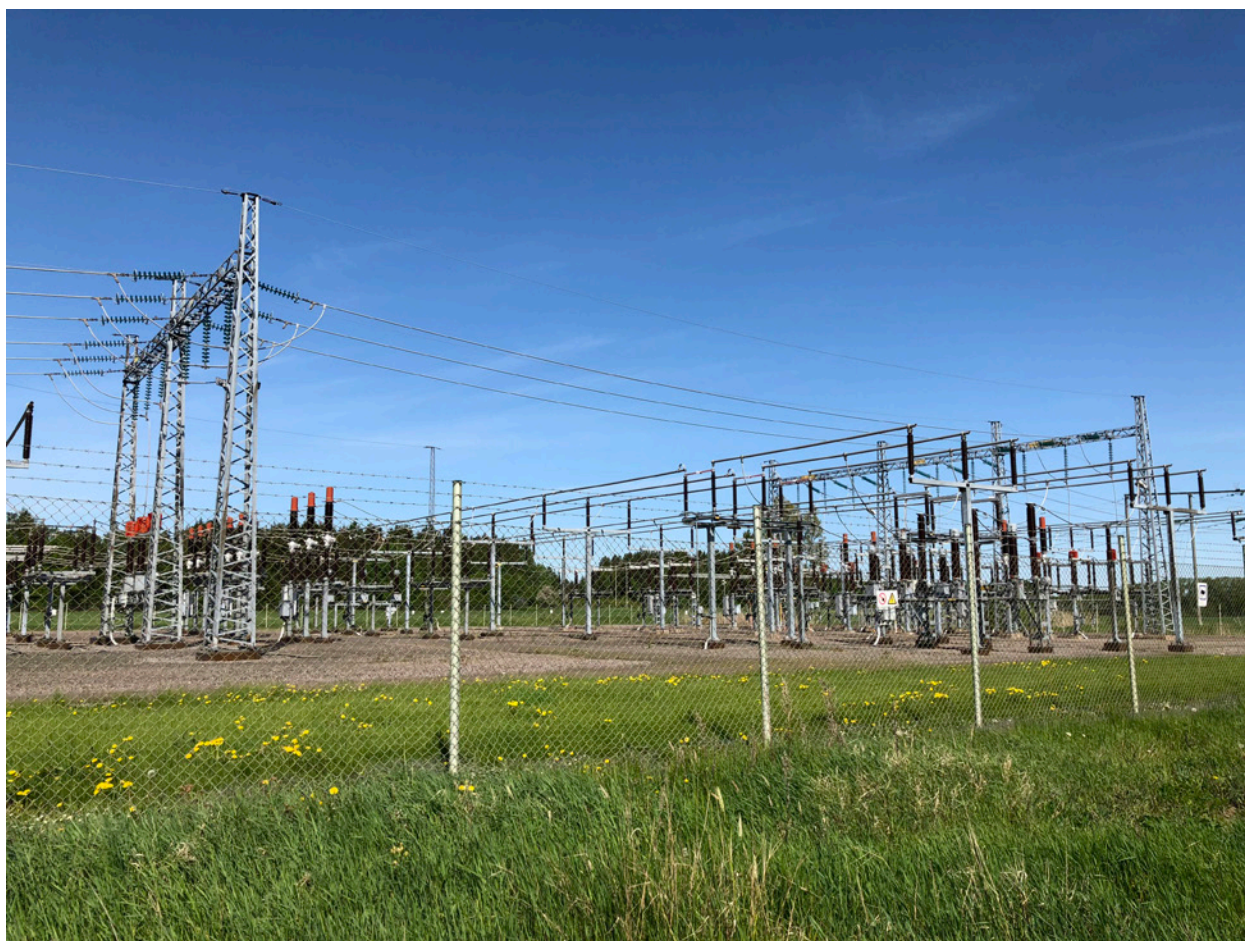
Figur 4.4. Ställverket sett från öster.
