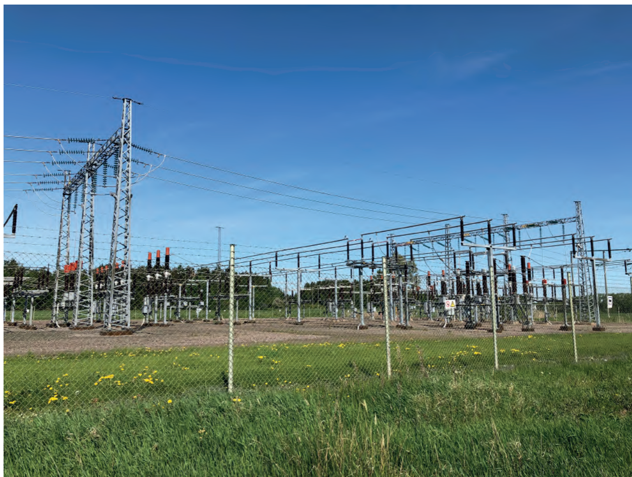
Figur 3.11. Ställverket sett från öster.
