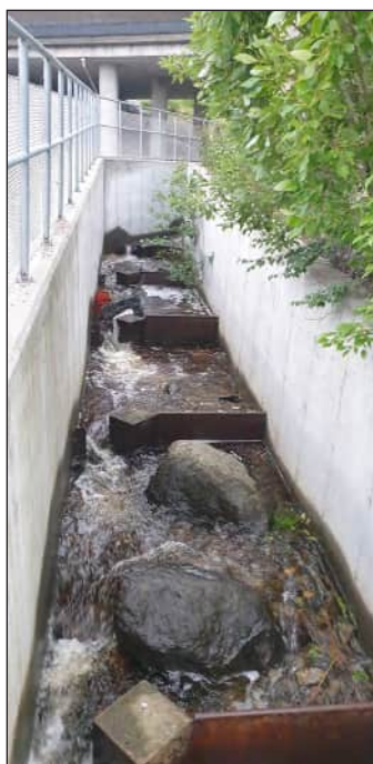
Figur 8.10:19 Fiskvägen under befintlig järnväg.
