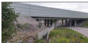
Figur 8.10:18 Bredsandsbäcken uppströms (väster om) E4 där fiskvägen börjar.
