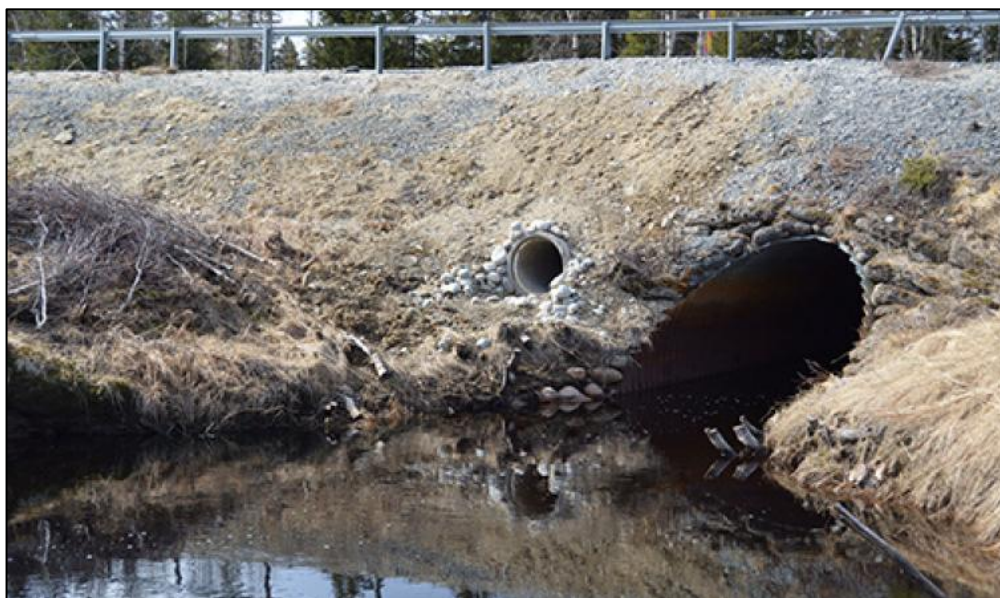
Figur 24. Exempel på torrtrumma (Trafikverket).
