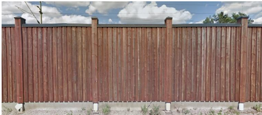
Figur 11. Tät grundläggning till bullerskärm kan säkerställa att utsläpp av vätskor inte kan lämna spårområdet. Exempel från Bergsbrunna.
