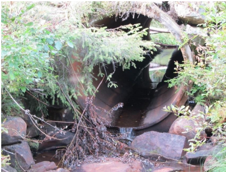
Figur 3.6.13. Vägtrumma vid Dönträskbäcken, som uppvisar vandringshinder i form av fall på nedströmssidan.
