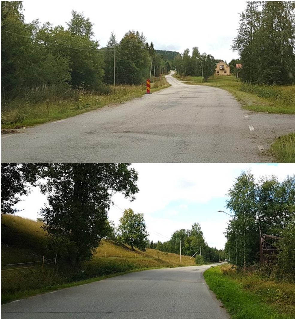
Figur 3. Övre bilden: exempel från parti av vägen med omfattande skador och ojämnheter i beläggningen. Nedre bilden: miljö i Lövberga.
