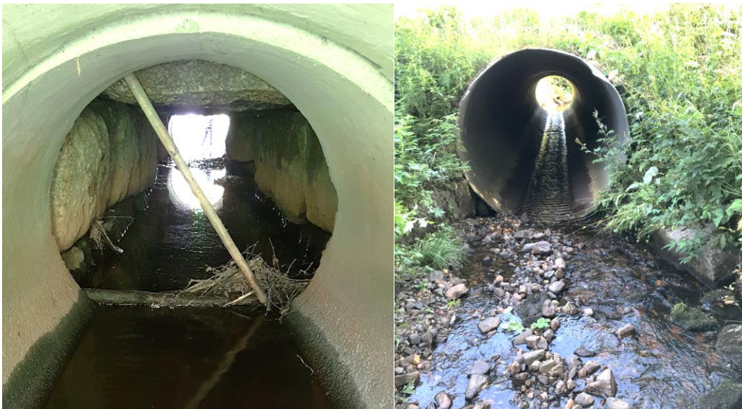
Figur 6. Under vägen finns ett 50-tal stentrummor varav flera är skarvade med betongtrummor (vänstra bilden). I väster- och öster Harrbäcken (bilden till höger) saknas naturligt bottenmaterial i vägtrummorna vilket försvårar passage för fisk och bottenlevande organismer.
