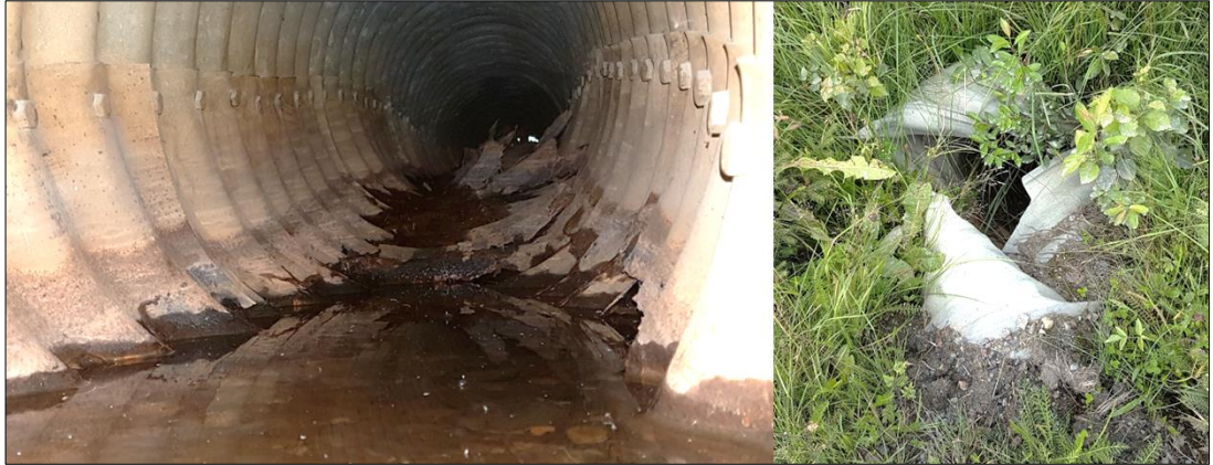
Figur 7. Många vägtrummor är i dåligt skick. Exempel på genomrostad och skadad trumma.
