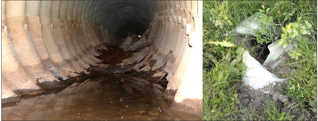
Figur 7. Många vägtrummor är i dåligt skick. Exempel på genomrostad och skadad trumma.
