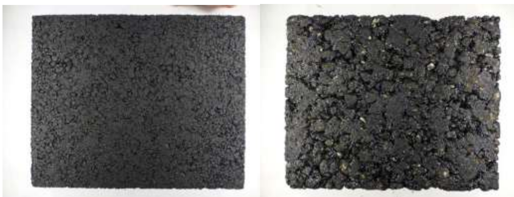
Figur 1. Asfaltsytor. Fin asfalt till vänster och grov asfalt till höger.
