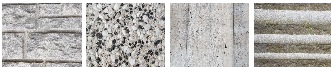
Figur 11. Material i och runt befintlig port. Matrisgjuten betong med brädform och murstensmönster, frilagd betong med sten i svart och vit färg, granittrappsteg med råkilat sättsteg och sågat plansteg.
