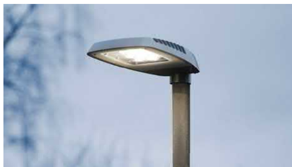
Bild 12. Exempel på stilren och diskret armatur.
