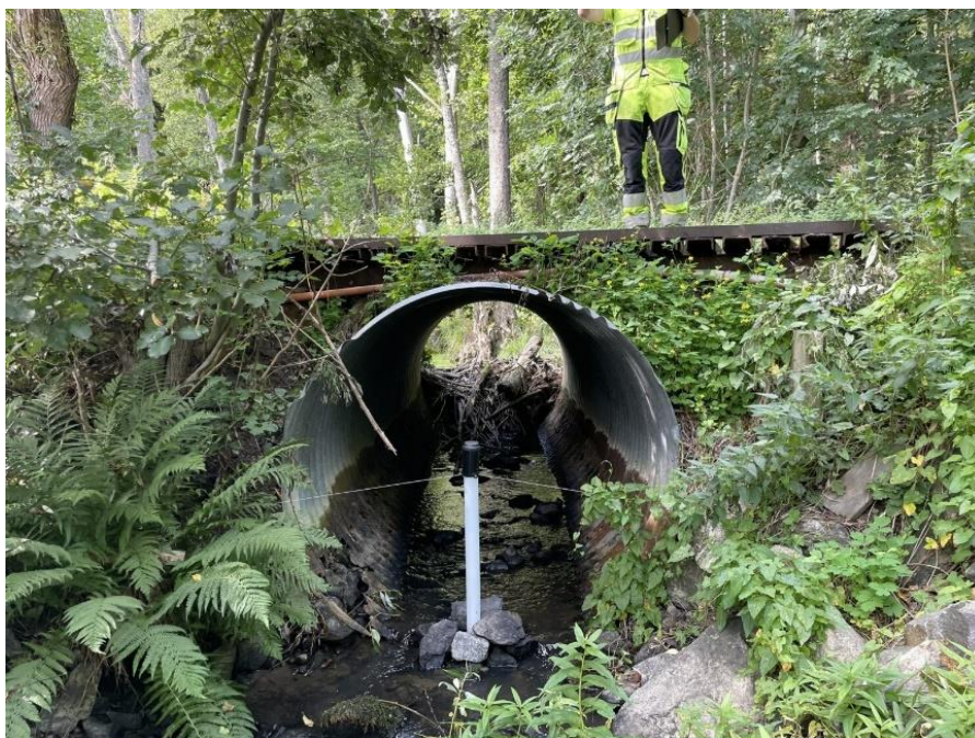
Figur 3. I trummans övre del har bråte ansamlats och skapar ett hinder för fiskars vandring.
